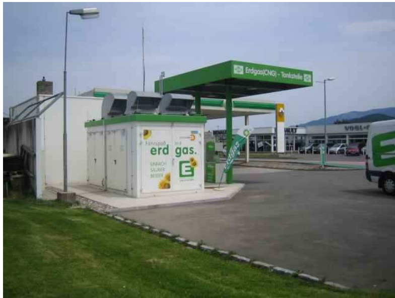
Erdgastankstelle mit Einhausung des Kompressors und des Hochdruckspeichers (HD Speicher)
