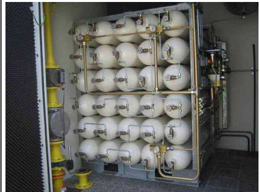
Erdgashochdruckspeicher (HD Speicher)
